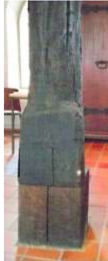
Abbildung 15: Fuß der 500 Jahre alten Holzsäule im Obergeschoss Foto: Norbert Hansen
